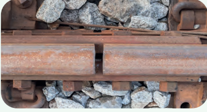
Tren raylarında demir parçalar arasında boşluk bırakılması
