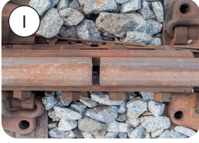
Kış aylarında tren raylarında boşluk olması
