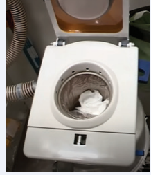
Vakumlu tuvalet sistemi
